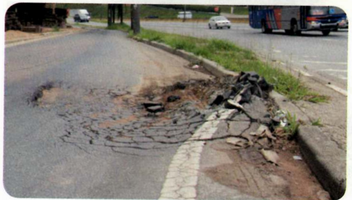
Danos no acesso a Estrada da Aldeia
