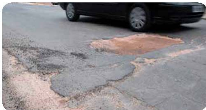
Estrada do Embu - calçadas não existem
