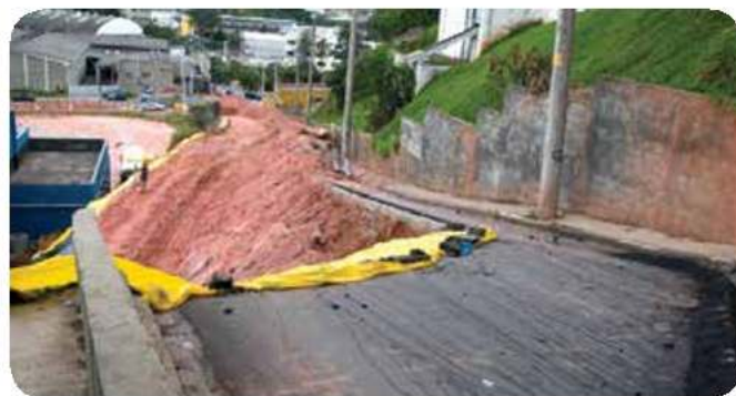
Estrada Velha de Cotia desmorona
